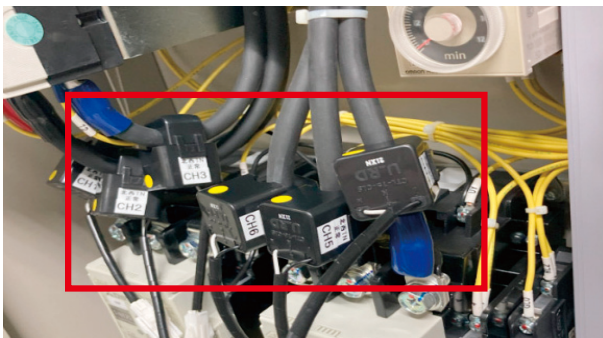
図3 電流センサ設置状況
