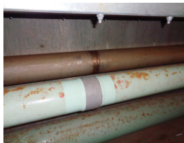
図2 既設配管腐食部
