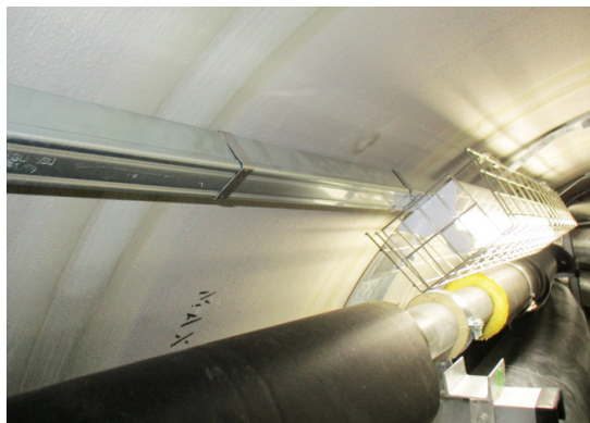
図2 専用洞道内 照明器具設置状況
