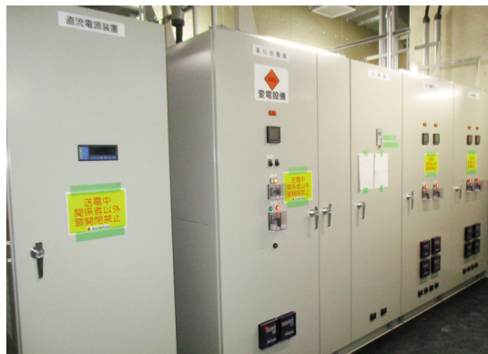
図7 受変電盤の据付状況
