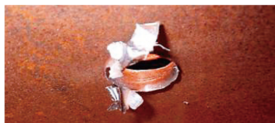
図3 管内バリ残り状況
