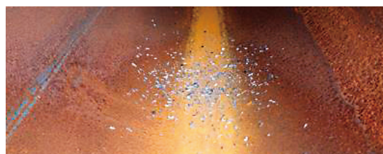
図4 管内切粉残り状況
