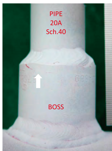
図4 漏えいした配管の浸透探傷試験の状況
