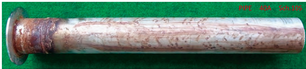
図 28 漏えいした配管の外観
