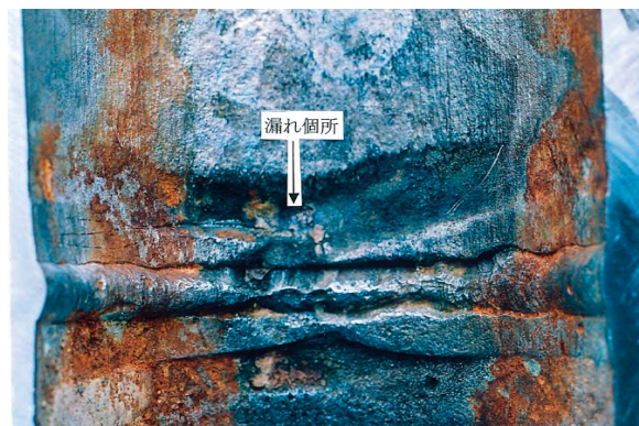
図15 漏えいした配管内面の状況
