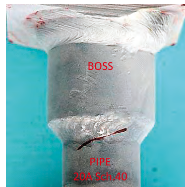
図 35 漏えいした配管の浸透探傷試験の状況
