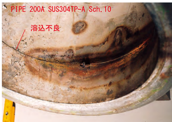
図 32 漏えいした配管内面の状況（溶込不良）
