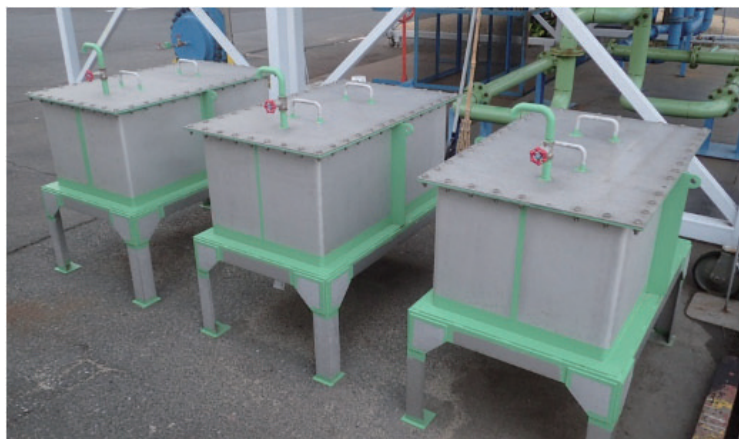
浸漬試験用のタンク（3基）
