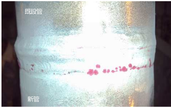
(a) 最初の溶接で発生した割れ
